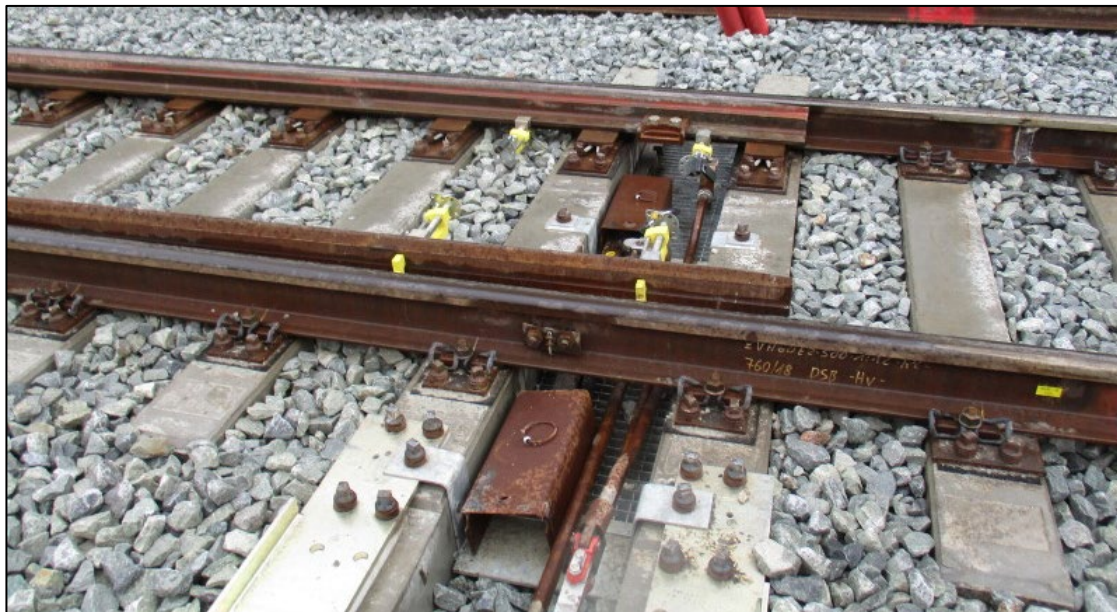
Billedet viser placering af de to låsebolte på til- og fraliggende tunger ved 1s drevs position
