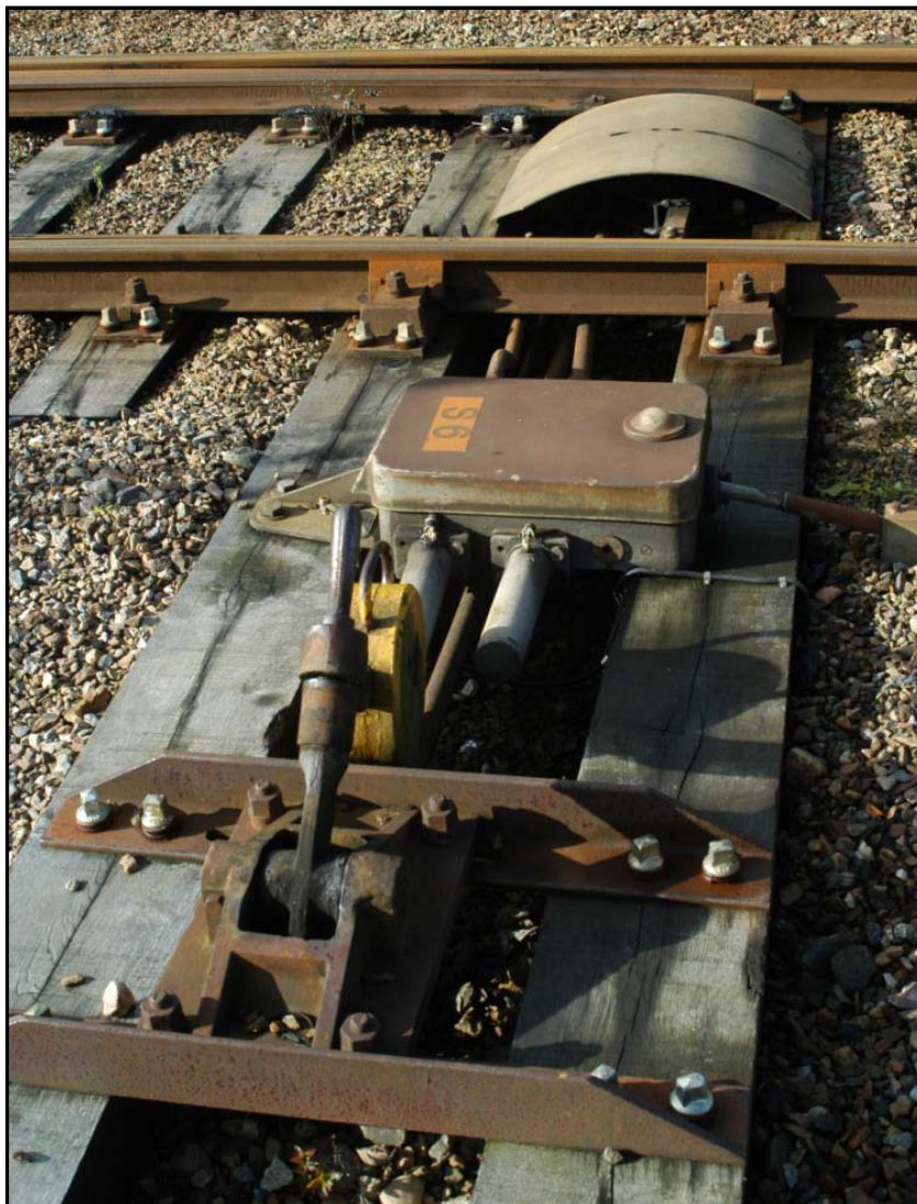
Centralaflåst sporskifte med magnetlås
