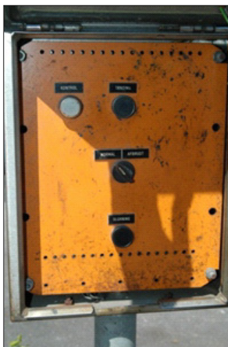
Betjeningskasse ved Nordkajen.
